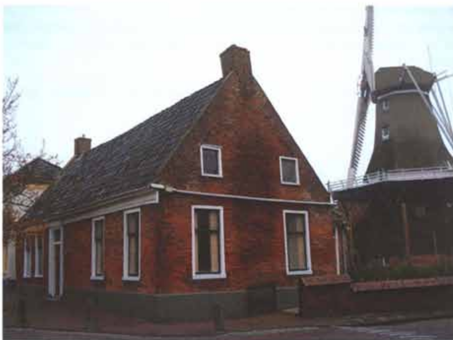
Foto 3.2 Scheurvorming in pand in de kern van Winsum
