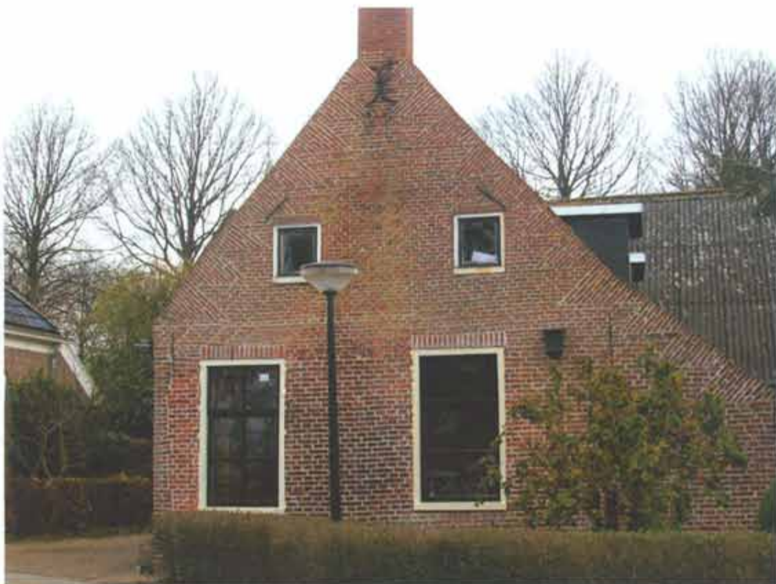
Foto 3.5 Pand met zettingverschijnselen in Baflo
